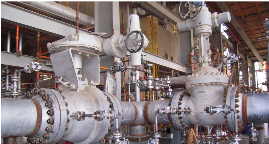
Vannes de cokéfaction Velan en phase de pré-mise en service.
