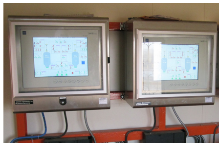
Velan a fourni des écrans tactiles pour afficher les informations sur l'état des vannes à l'intention des travailleurs dans les zones dangereuses de la raffinerie.
